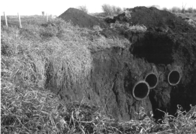
Figura 3 – Deságüe das águas em área agrícola sem dissipador de energia, notando-se o desmoronamento do barranco causando sulcos profundos à jusante
