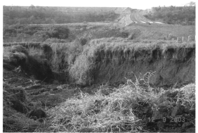
Figura 4 – Voçoroca provocada pela condução inadequada da drenagem do escoamento superficial das águas pluviais em áreas adjacentes à rodovia.
