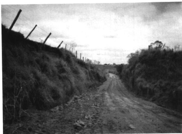
Foto 5 - Estradas com sérios problemas e deficiência de drenagem
