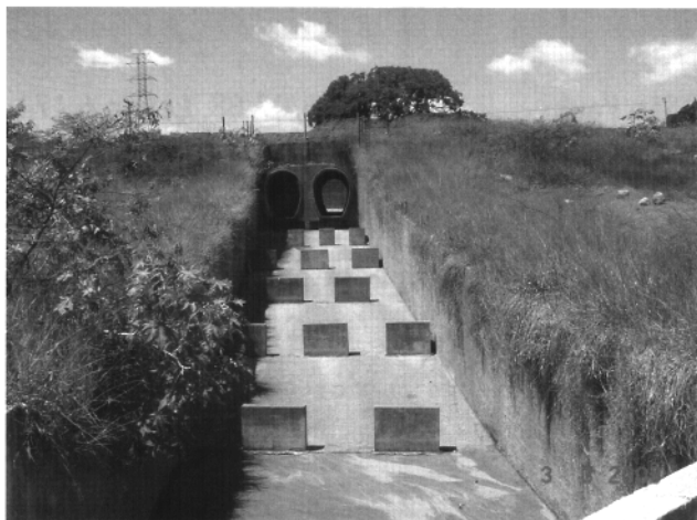
Foto 12 - Canalização da água pluvial com dissipadores de energia
