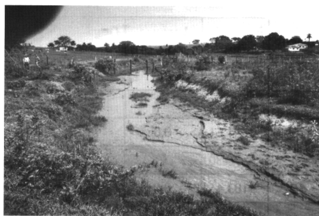
Foto 2 - Assoreamento do Córrego Águas Claras, causado por carreamento de solo da Estrada Municipal CTV-020
