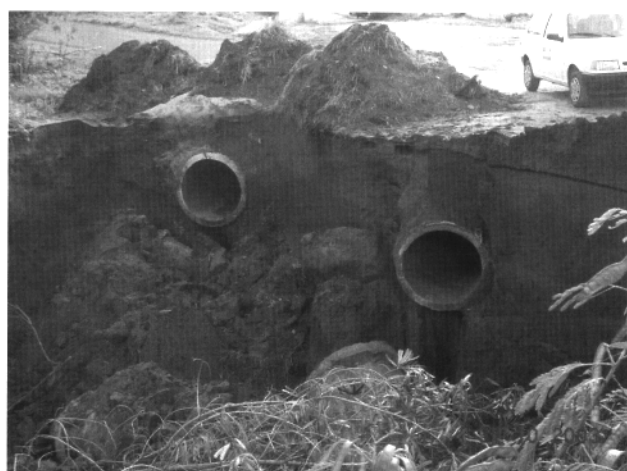
Figura 5 - Voçoroca na estrada municipal que dá acesso a Thermas e APAE – tubulação de captação das águas pluviais do perímetro urbano
