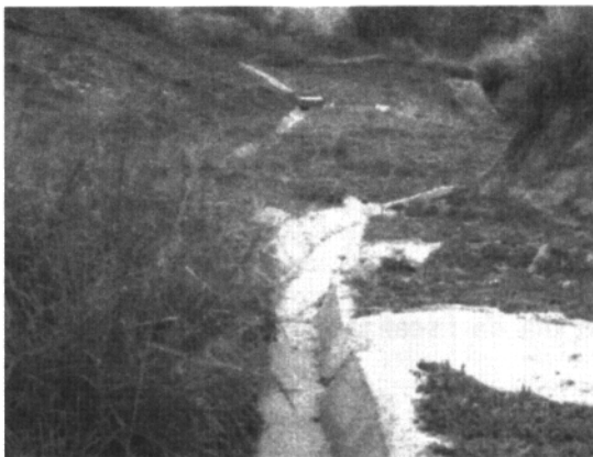
Foto 3 – Aspectos de escadas hidráulicas implantadas no local
