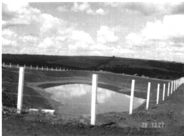
Figura 3 - Bacias de contenção após escada hidráulica na SP 334 km 327,7
