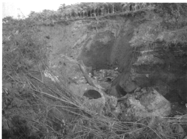
Foto 4 - Voçoroca na estrada municipal que dá acesso a Thermas e APAE – tubulação de captação das águas pluviais do perímetro urbano
