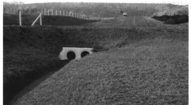
Figura 2 – Entrada das águas pluviais das áreas adjacentes da rodovia em uma tubulação subterrânea
