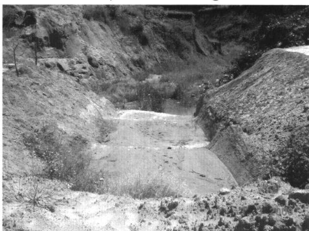
Foto 14 - Ponto de descarga das águas pluviais em escadaria
