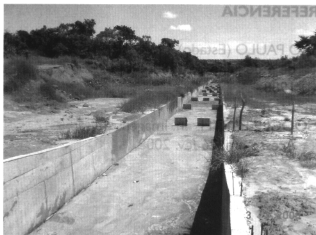
Foto 13 - Canalização da água pluvial com dissipadores de energia
