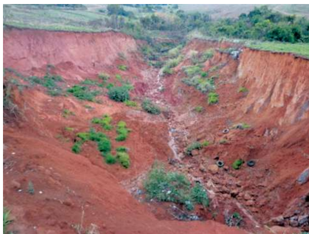
Figura 7 – Ocorrência de voçoroca
