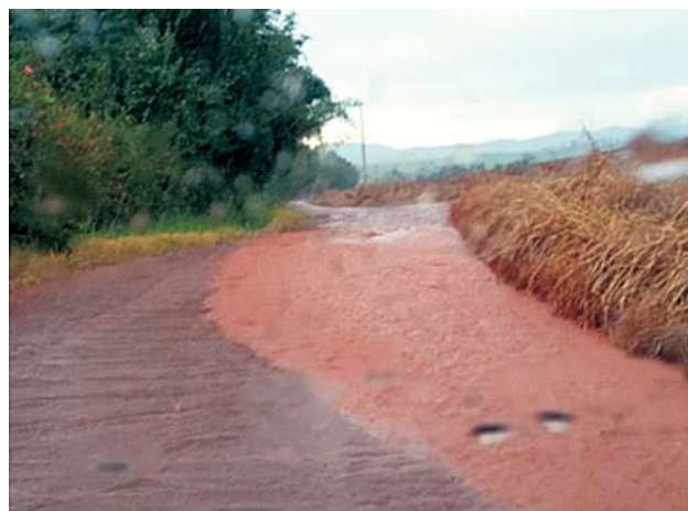
Figura 9 – Contribuição das estradas rurais para a ocorrência de erosões em Áreas de Preservação Permanente, com saída d'água junto ao córrego.
