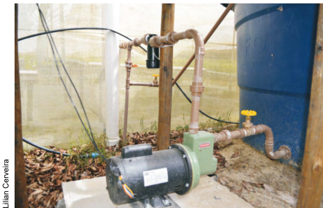
Figura 23 – Motobombas na superfície
