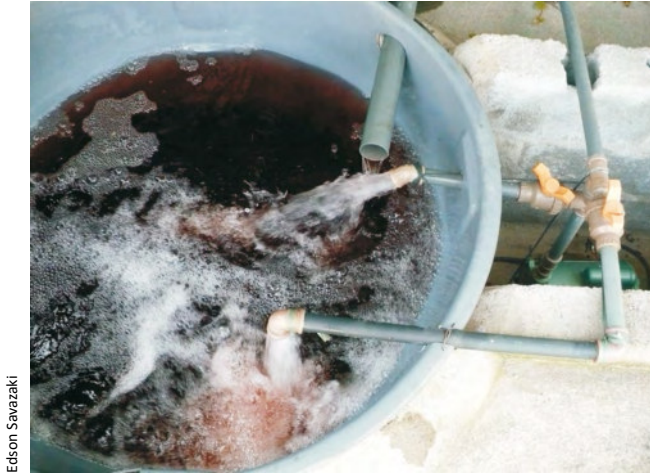
Figura 22 – Bombeamento com retorno para garantir agitação e oxigenação
