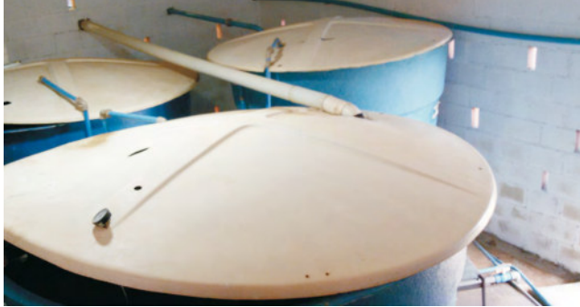
Figura 19 – Reservatório de fibra de vidro protegido com tampas – abaixo do nível do solo
