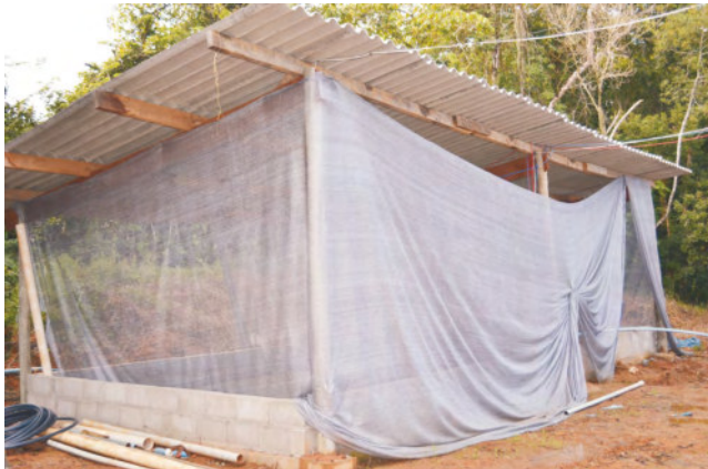
Figura 21 – Reservatório protegido de insolação – sombra
